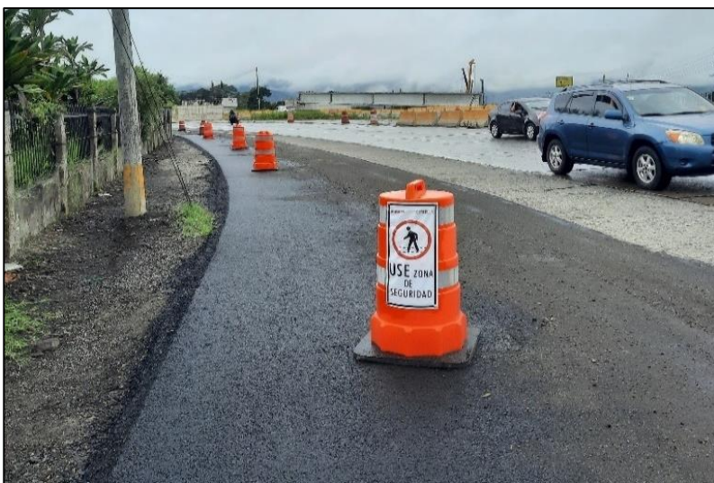
Ilustración 33 Estado de los pasos peatonales
