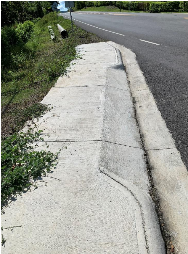
Ilustración 8: Rampa en acera con pendientes mayores a las establecidas en la Ley 7600
