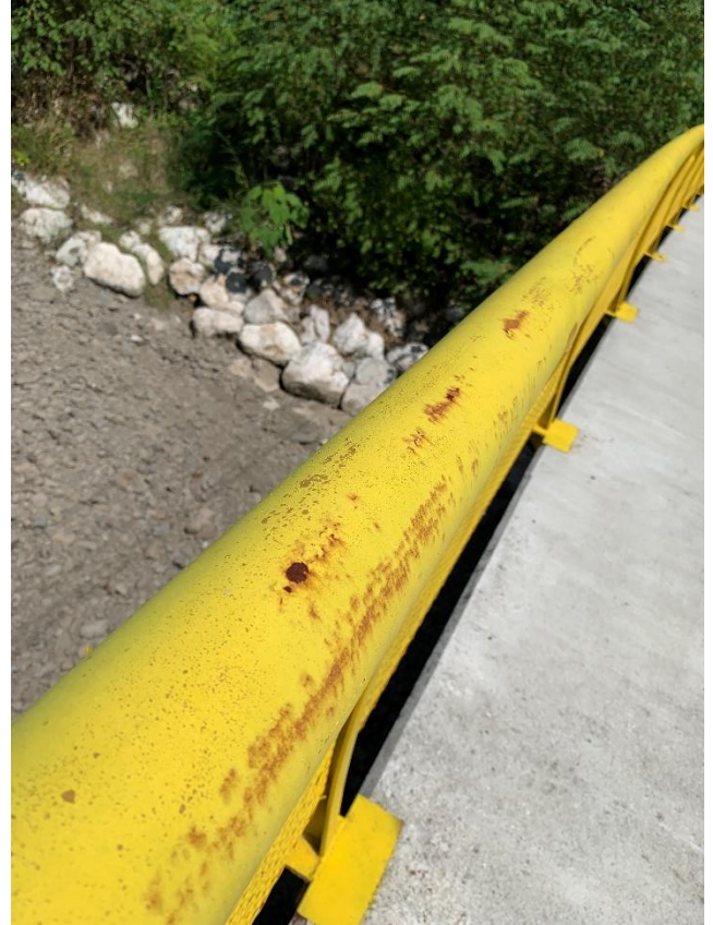
Ilustración 21: Barandas de puentes con oxidación evidente.
