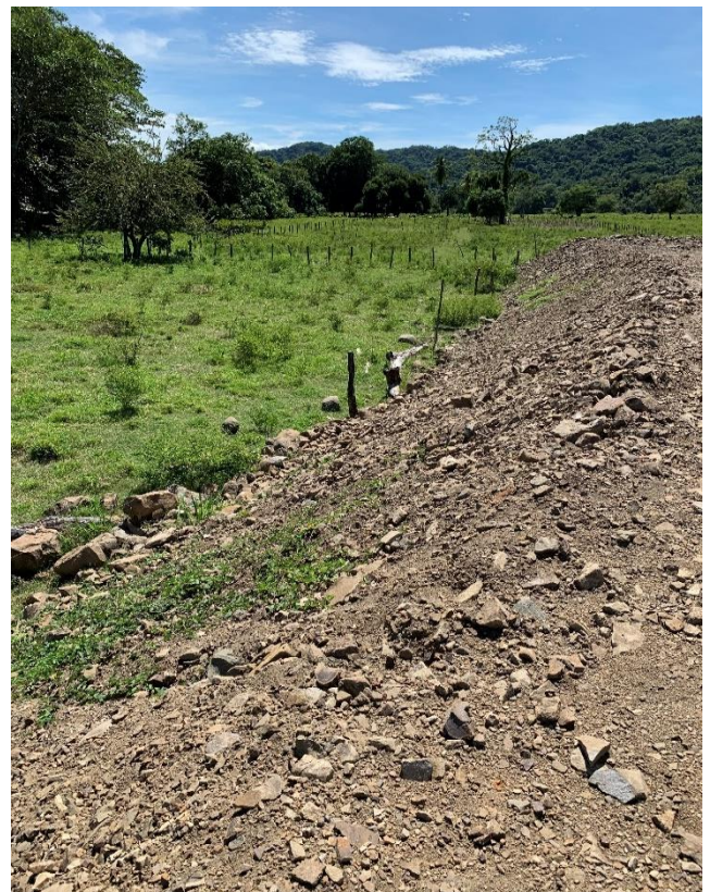
Ilustración 42: Escombrera mal construidas.
