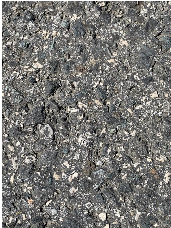
Ilustración 2: Patología en mezcla asfáltica
