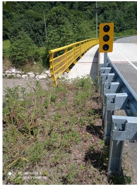
Ilustración 70 elementos de seguridad en mal estado
