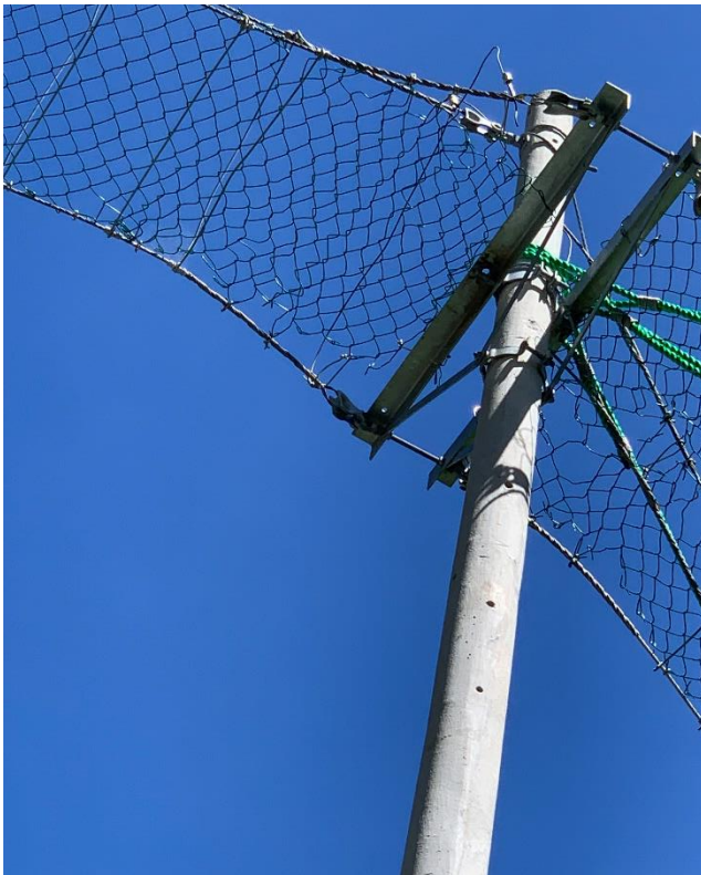
Ilustración 10: Malla mal colocada en paso de fauna superior.
