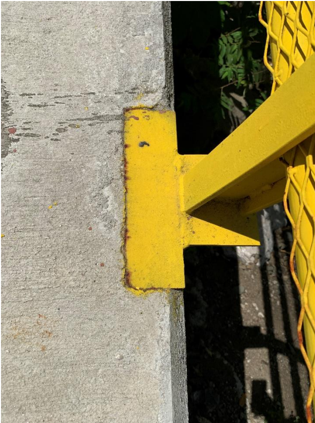
Ilustración 22: Soportes de barandas de puentes con oxidación evidente.
