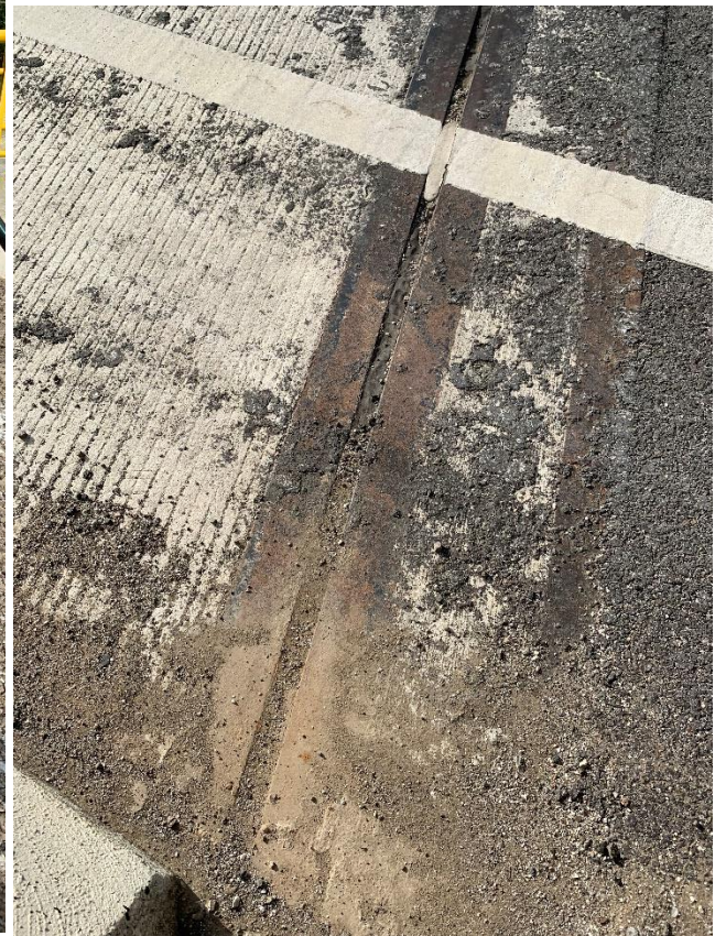
Ilustración 23: Juntas de expansión en puentes con deficiencias.
