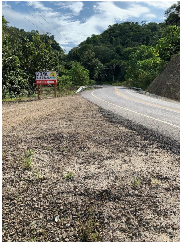
Ilustración 53: Intersección, hacia Playa Gitana, sin transición adecuada.
