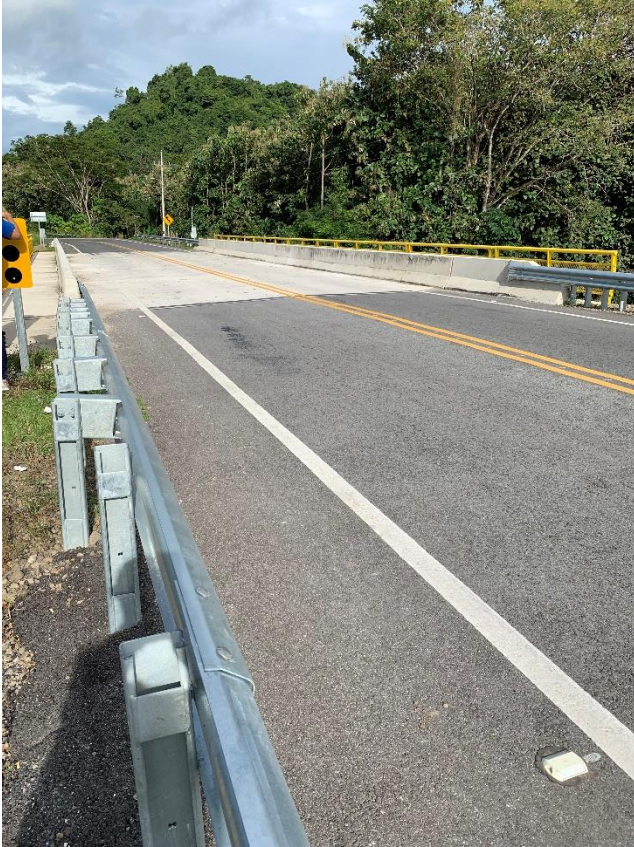
Ilustración 29: Baranda flexibles que impiden el acceso a la acera.
