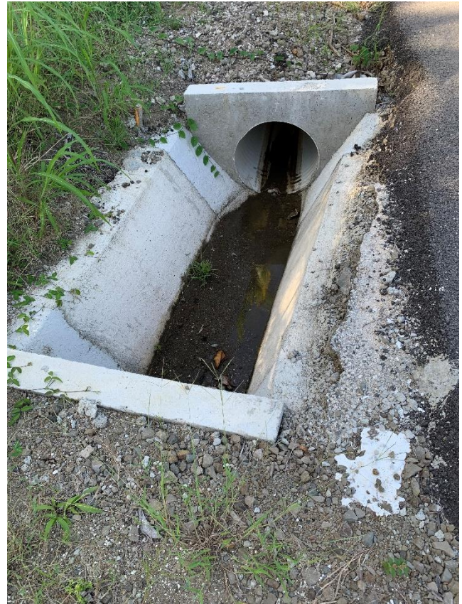
Ilustración 19: Sedimentos por arrastre en canales pluviales.
