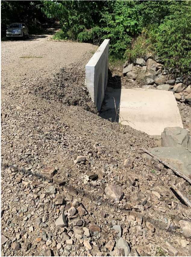
Ilustración 16: falta de aletones de soporte.
