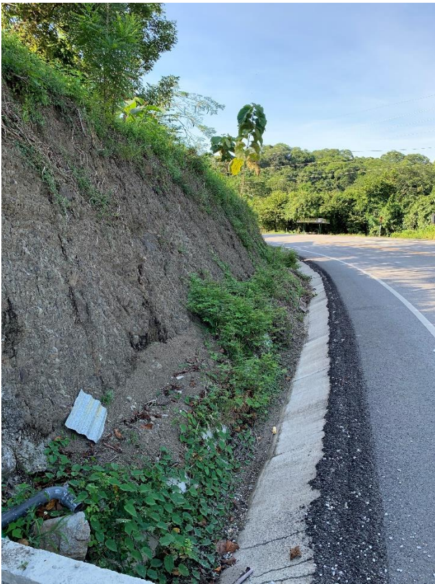
Ilustración 38: Talud sin control de erosión.
