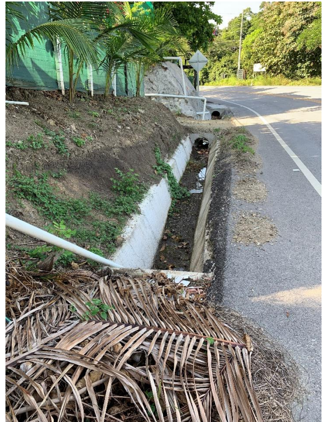
Ilustración 49: Canales con sedimentos al frente de viviendas.
