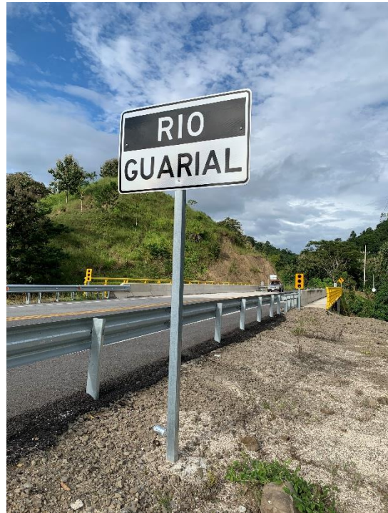
Ilustración 5: señal vertical con altura y retiro inadecuado.
