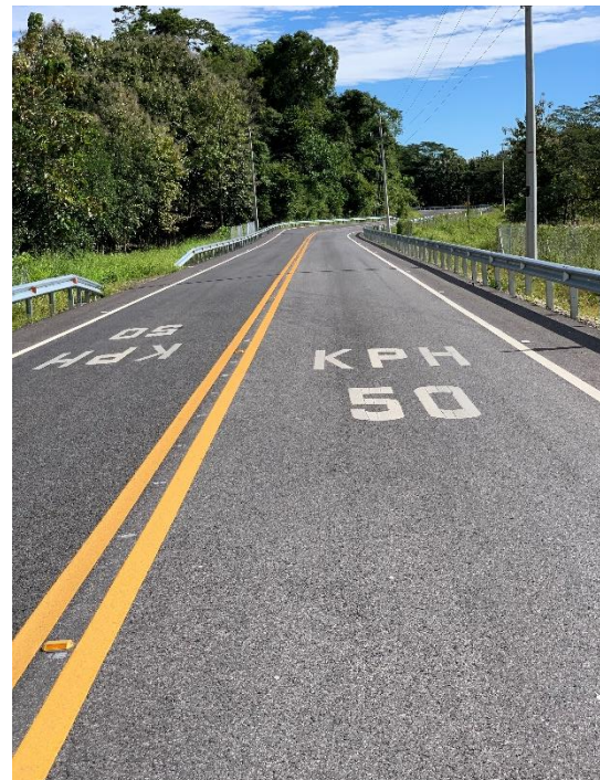
Ilustración 7: Falta de señalización vertical de límite de velocidad.
