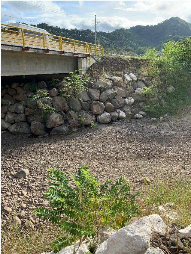
Ilustración 25: Rellenos de aproximación sin protección.
