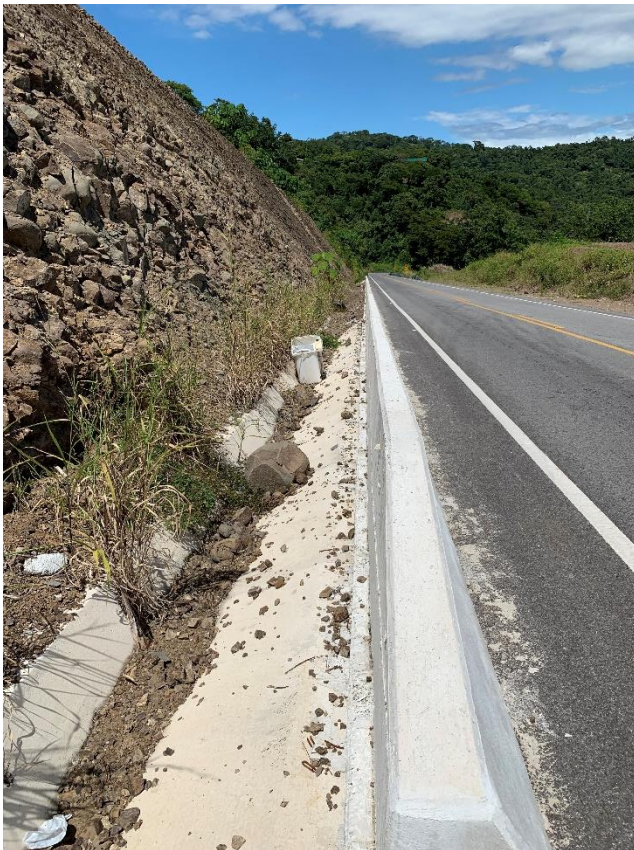
Ilustración 20: Sedimento en cunetas por erosión y desprendimiento de material en taludes
