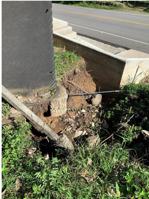
Ilustración 48: Daños en estructuras por falta de control de agua.
