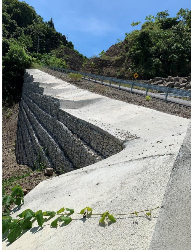
Ilustración 33: Solución de contención sin adecuada canalización de aguas pluviales
