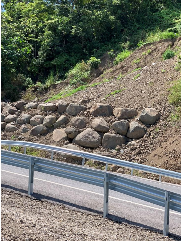
Ilustración 34: Enrocado totalmente inadecuado para el talud.
