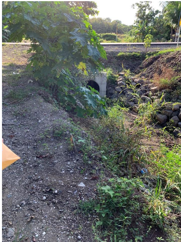
Ilustración 47: Problemas de erosión en propiedad privada por canalización del proyecto.
