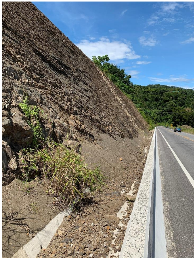
Ilustración 36: Erosión y colapso de drenajes en pie de talud.
