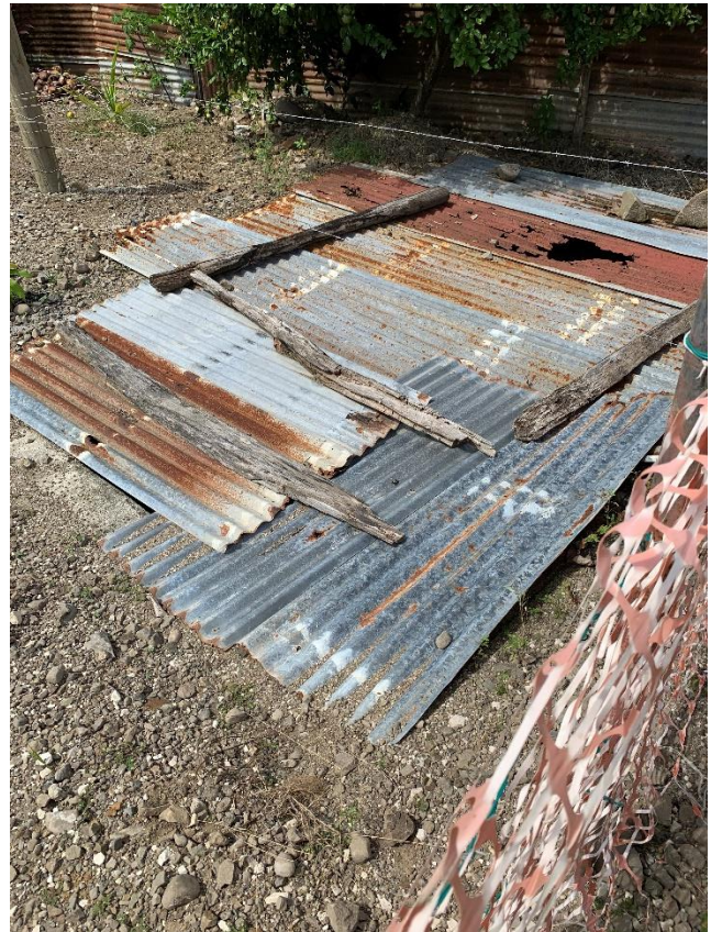
Ilustración 51: Caja pluvial sin tapa de protección, laminas colocadas por los vecinos.
