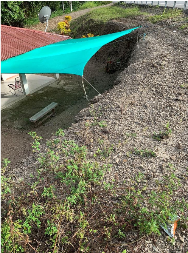
Ilustración 43: Relleno de aproximación a un puente, modificado por el propietario.
