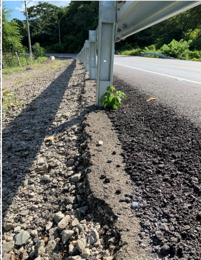
Ilustración 12: socavación en bordes de pavimento.
