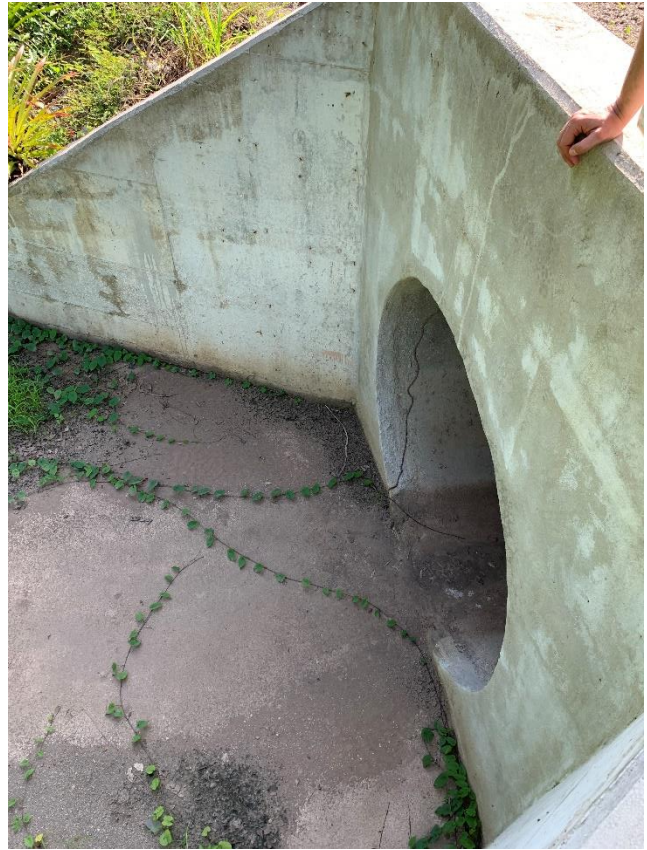
Ilustración 15: Fisuras en tuberías de concreto.
