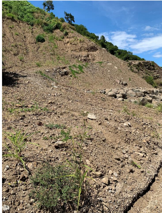
Ilustración 39: Talud con deterioro elevado.
