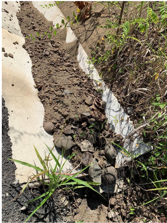
Ilustración 37: Material de erosión en cunetas por falta de medidas de control de erosión.
