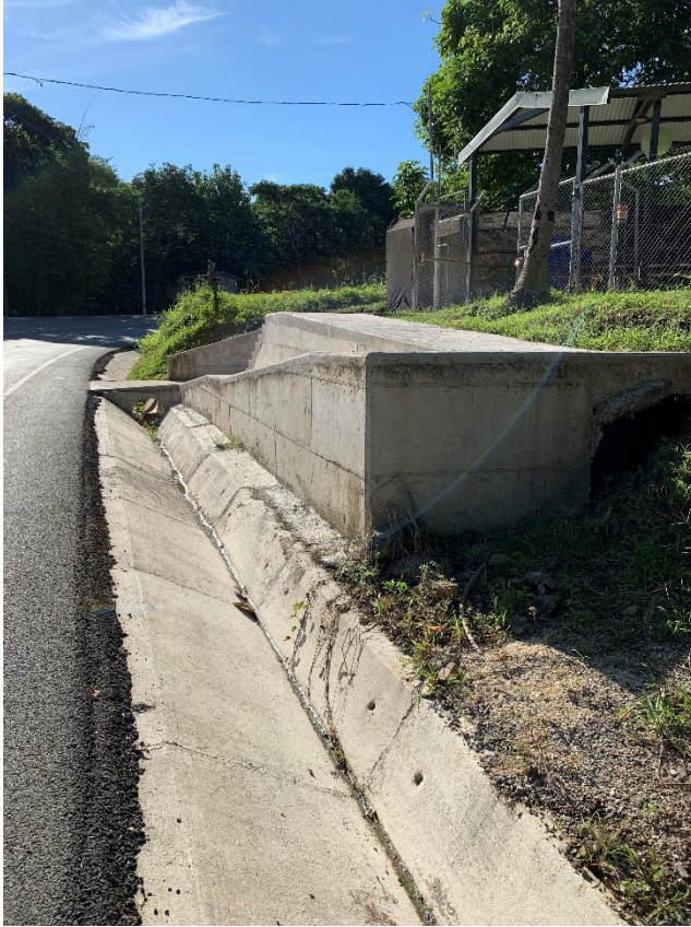
Ilustración 46: Rampas y gradas sin barandas.
