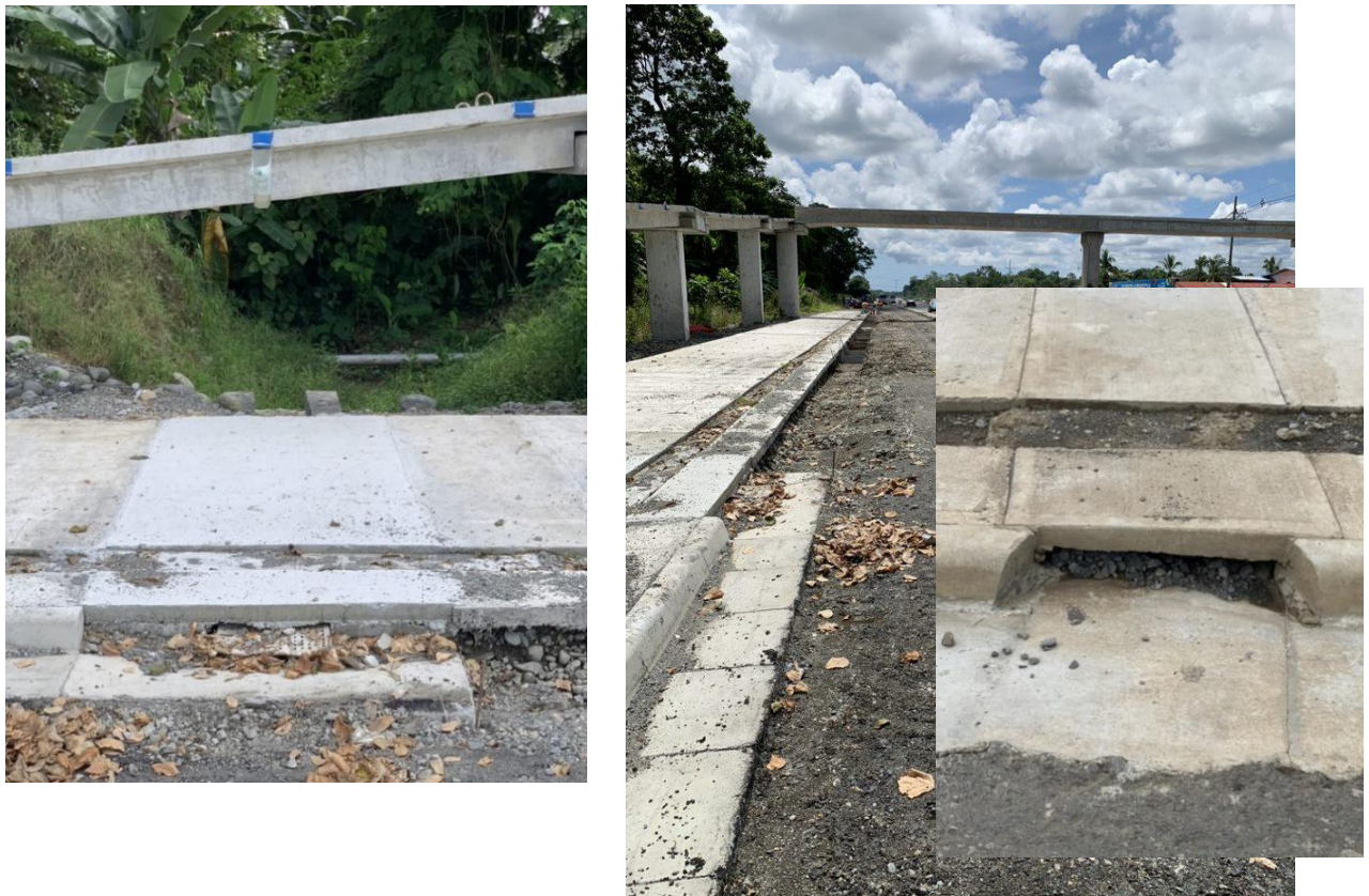
Ilustración 3 Sedimentos en cunetas y mal mantenimiento.
