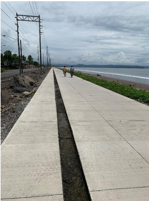
Fotografía 3: Acera prevista para elementos podotáctiles
