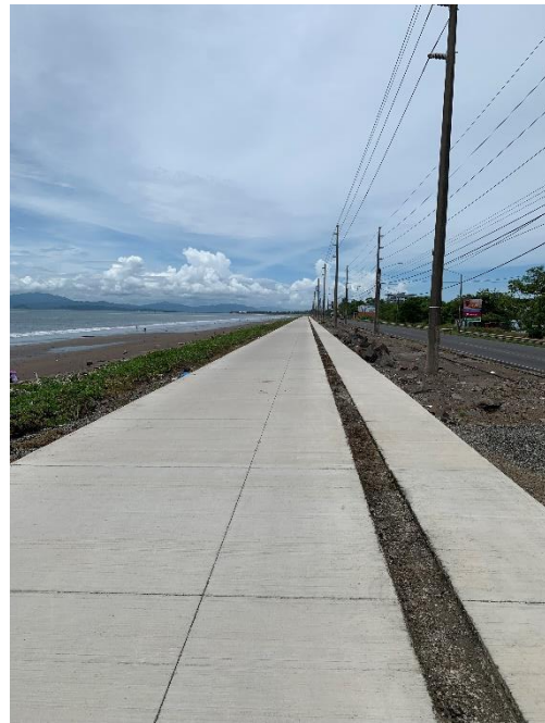
Fotografía 4: Acera prevista para elementos podotáctiles.
