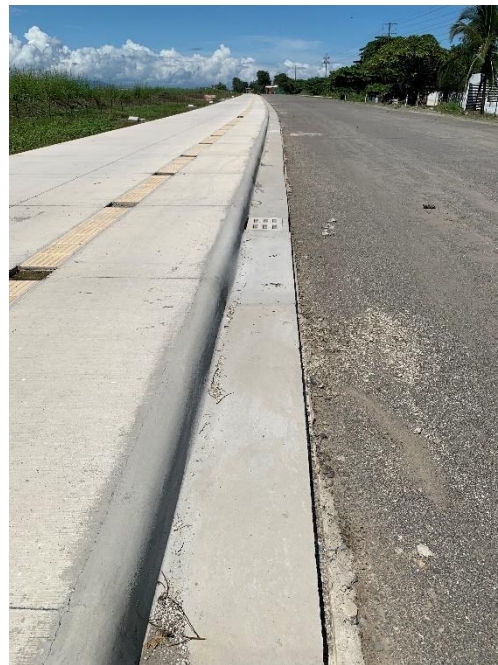
Fotografía 24: Cordón y caño con tragante.
