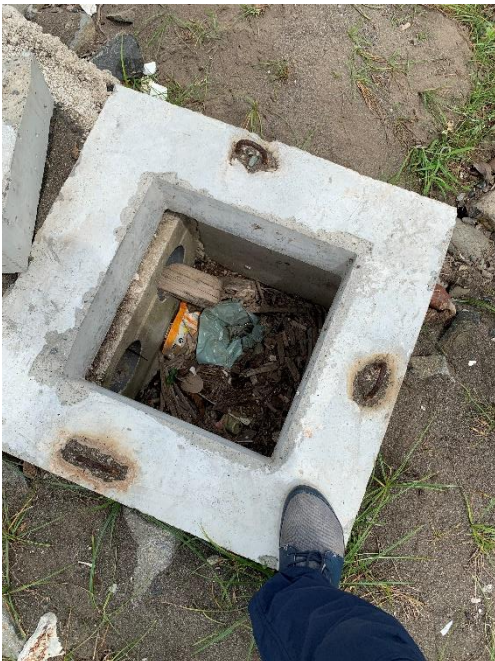
Fotografía 30: Filtro de grava.
