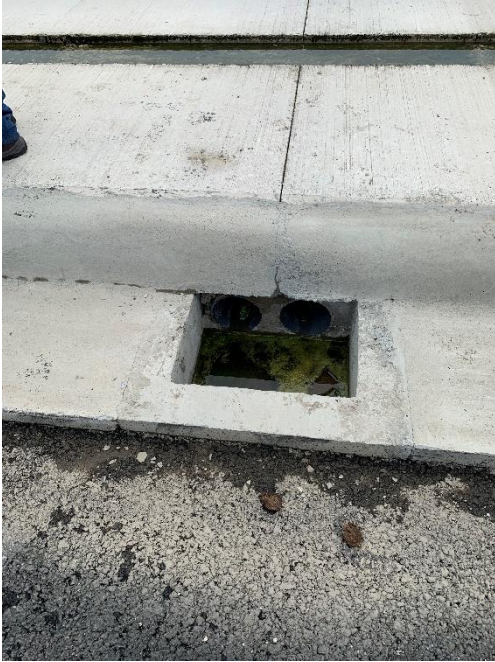
Fotografía 28: Sistema de tragantes pluviales.
