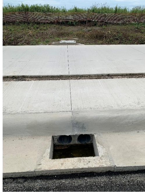
Fotografía 29: Sistema de tragantes pluviales.
